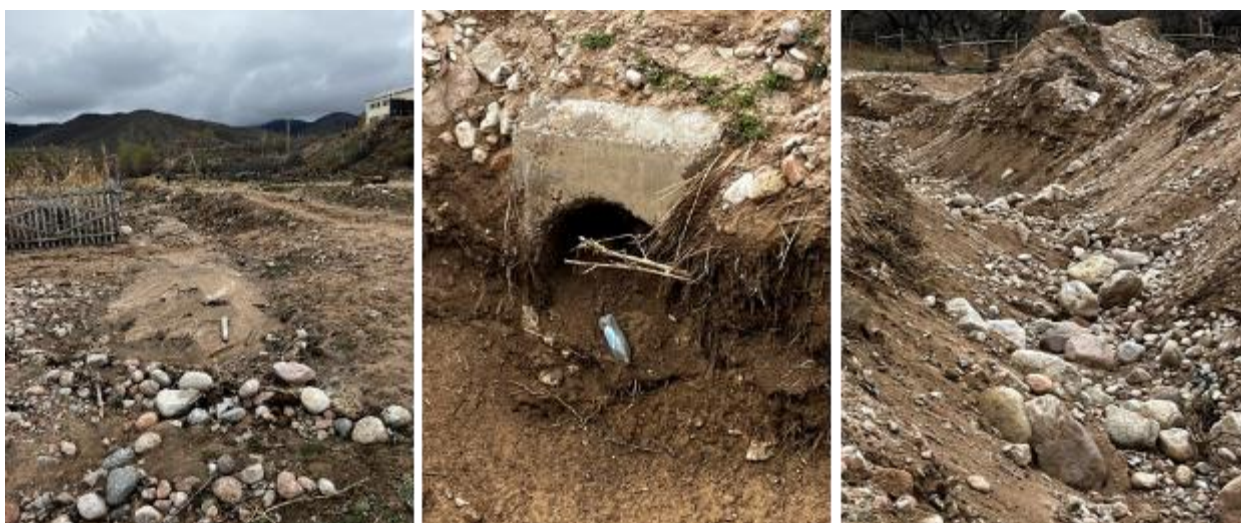
Рис. 69: Засорение водопропускной трубы на участке КМ 155
