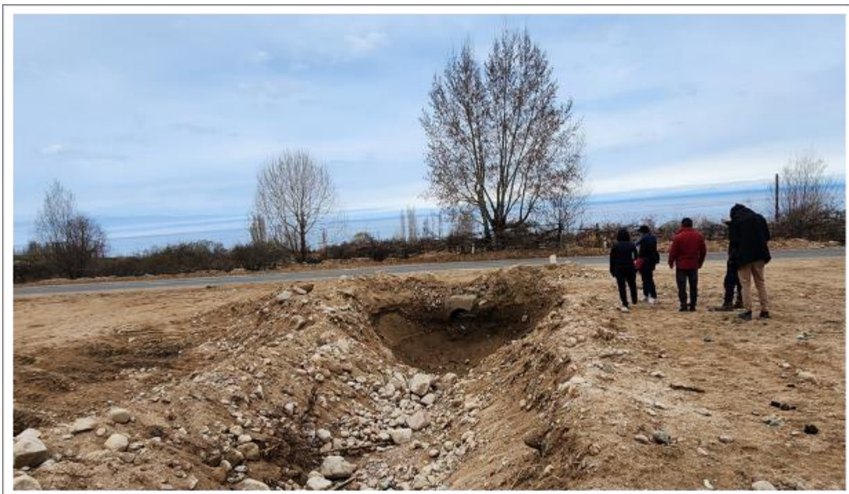
Рис. 190: Участок дороги, недавно пострадавший от затопления в районе села Кичи-Жаргылчак (КМ 151+70) из-за водопроводной трубы/водопропускной трубы недостаточного размера (10 апреля 2023 г.)
