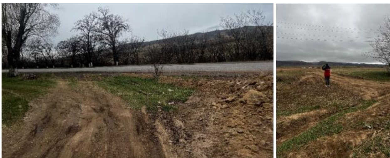
Рис. 71: Участок дороги, подверженный воздействию снежных заносов/потоков в зимний период
