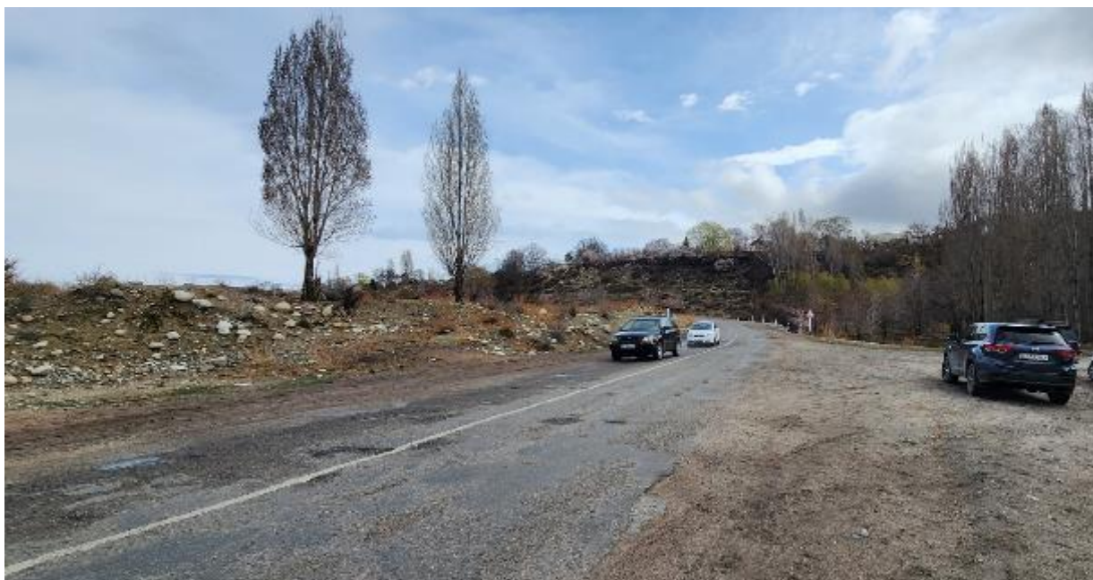
Рис. 6: Разрушенный участок дороги вблизи Барскоона
