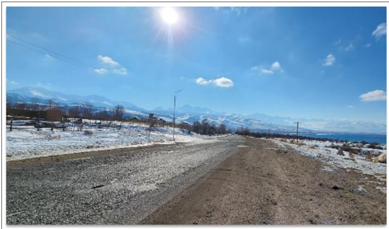
Рис. E2: Текущее состояние дороги
