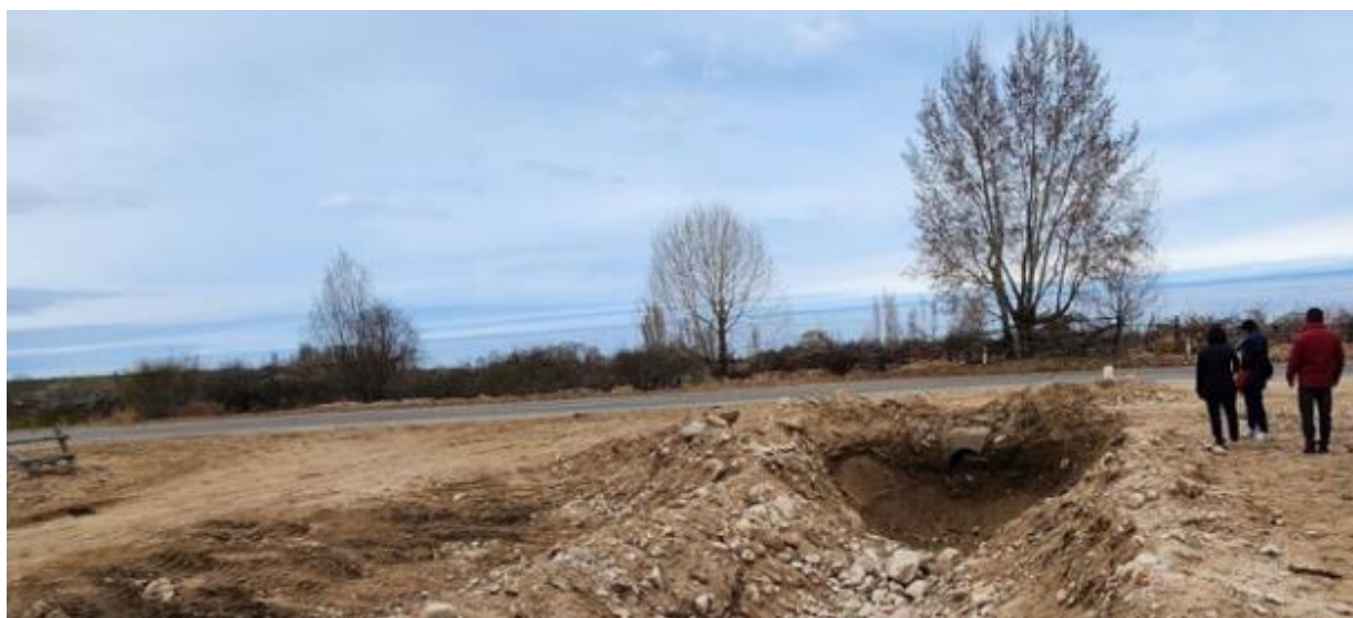
Рис. 203: Участок дороги, недавно пострадавший от затопления (КМ 151+70, 42°12'45.57"N; 77°42'6.94"E) у села Кичи-Жаргылчак из-за некачественной водопроводной трубы/водостока (10 апреля 2023 г.).
